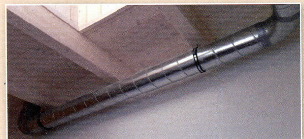
Conductos de ventilación de chapa.
